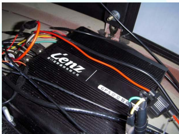
图 9-2 车内 LED 屏内 ( 隐蔽安装 )
