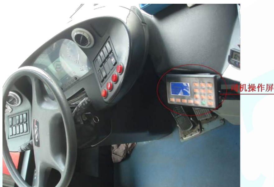
图2-4 司机操作屏安装
